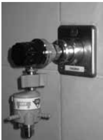
FIGURA 1. Toma central de oxígeno.
